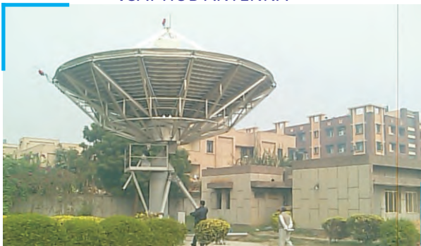
VSAT HUB ANTENNA
